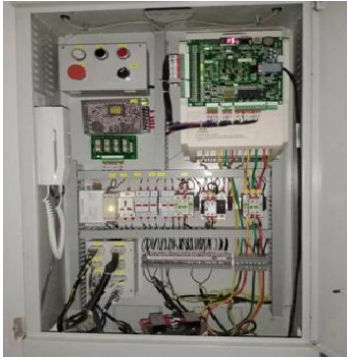
图 1-2 机房控制柜保养
